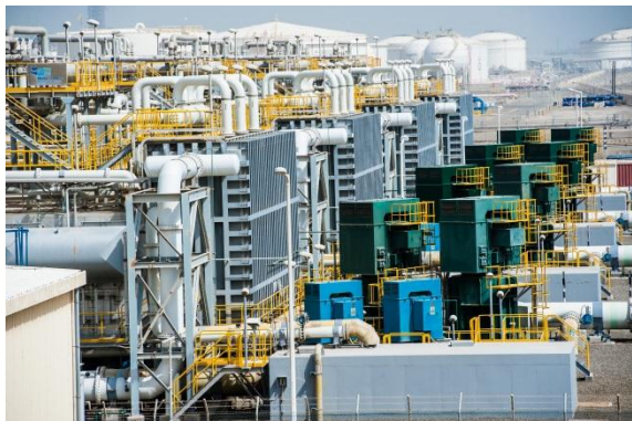
Centrale électrique au gaz naturel, Sohar II, au Sultanat d'Oman
